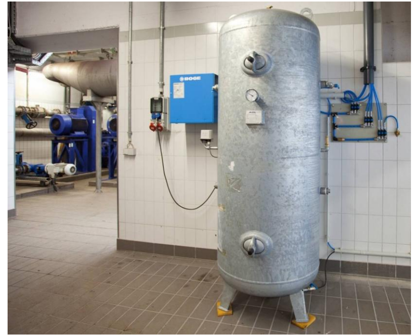
Druckluftspeicher mit Trockner und Verteilung
