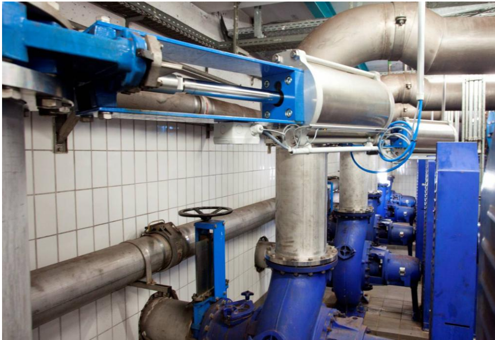
Pumpen mit Schiebern und pneumatischen Linearantrieben
