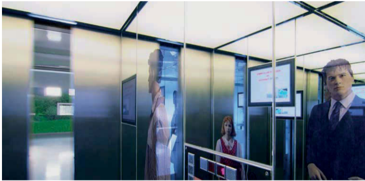
Eingangssituation: Verspiegelter Raum führt als Lift automatisch gesteuert in das Erste Obergeschoß zum Empfang im Foyer.
