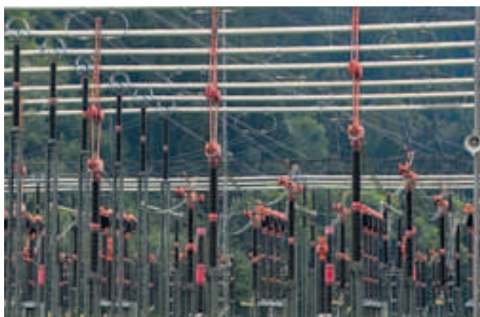
Die passende Energietechnik hilft dabei, die Verluste in der Stromerzeugung, aber auch in der -übertragung und -verteilung zu minimieren.
