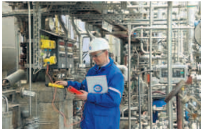
Energieeffiziente Anlagentechnik: Für die Zertifizierung vergleichen die TÜV-Süd-Experten den Ist-Zustand einer Anlage mit möglichen Einsparungen.
